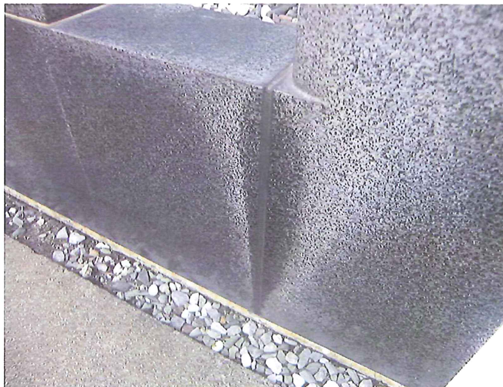
シリコーン系シール材による石材汚染
